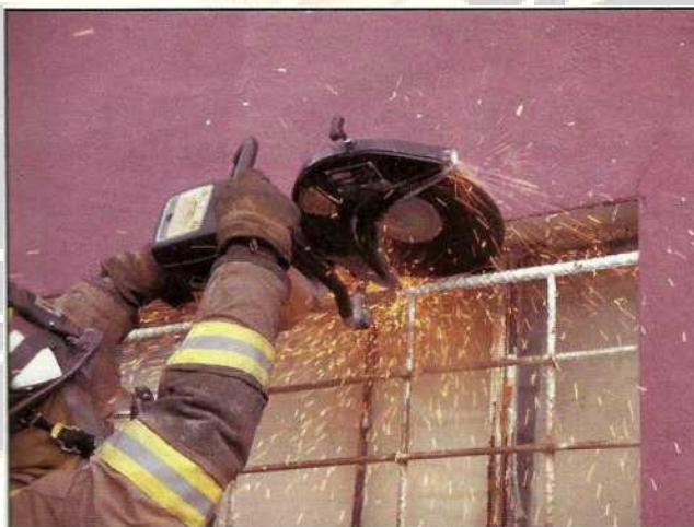
Fot13.114Tăiați punctele de unire ale unei grătili de securitate va permite îndepărtarea celor bari
