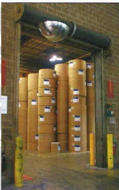
Fot13.60 Una ușă contrafuego asupra încărcată cu laminare de oțel ce separă două zone de o magazie.
