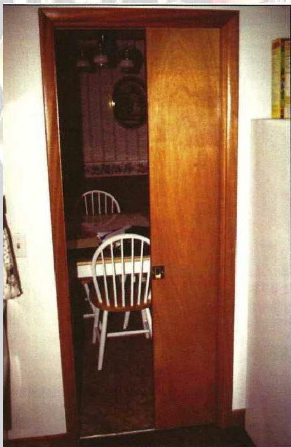
Fot13.44 O ușă glisantă parțial închisă găsită în o casă rezidențială.
