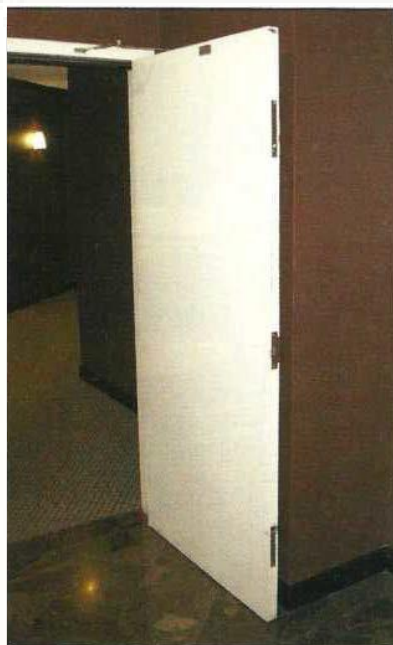
Fot13.59 Ușile cortafuego care se închid automatic și sunt folosite comunamente întâlnite în școli, spitale, și locuri de adunare.
